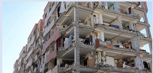
(شکل ۱-۲) عدم مهار دیوارها و تخریب کامل آنها در زلزله
